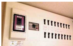
ブレーカーの一例
